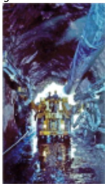
Fig.5 - Miniera di Val Vedello (SO) – anni '80. Livello Ribasso. Mezzo gommato con 2 bracci di perforazione - Foto: C.M. Pessina.
