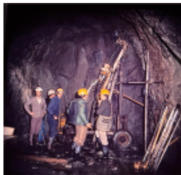
Fig.6 - Miniera di Val Vedello (SO) – anni '80. Livello 2. Esplorazione del livello uranifero con sonda Diamec 250. Foto: C.M. Pessina
